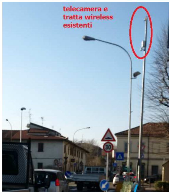
Foto 16 – Palo telecamera esistente per raccordo rete wireless e alimentazione
